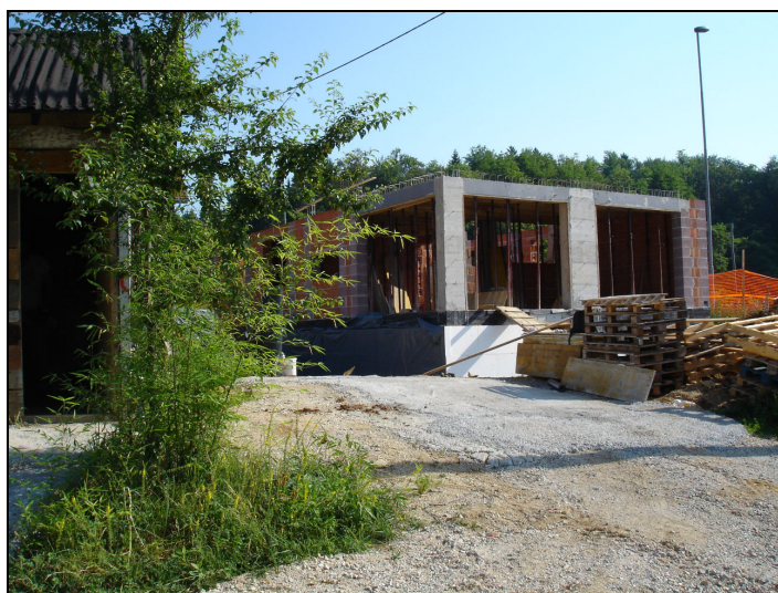
- novogradnja na lokaciji Ljubljanska cesta 113 ob bodočem cestnem priključku v območje delnega OPPN -
