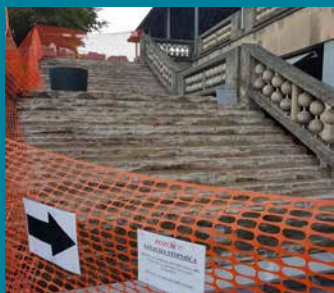
Urejanje osrednje avtobusne postaje smo nadaljevali s preno-vo dotrajanega stopnišča. Peter Žunič Fabjančič
