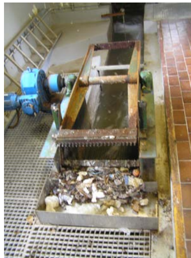
Slika 5.2: Avtomatska ločna rešetka na ČN Dolenjske Toplice
