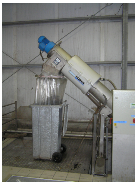
Slika 2: Odpadki rezervnih grabelj Ro 11
