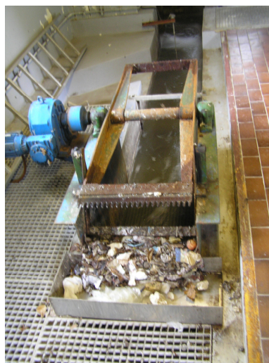
Slika 2: Avtomatska ločna rešetka na ČN Dolenjske Toplice
