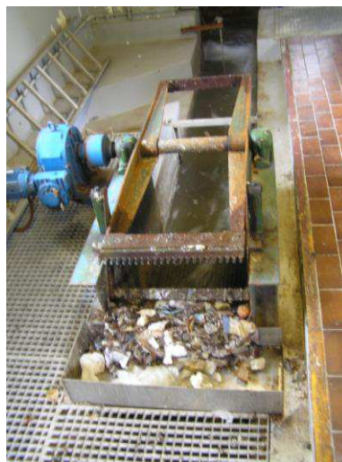
Slika 5.2: Avtomatska ločna rešetka na ČN Dolenjske Toplice
