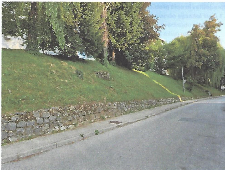
Slika 2: Brežina na levi strani ulice gledano v smeri centra (parc. št. 182)
